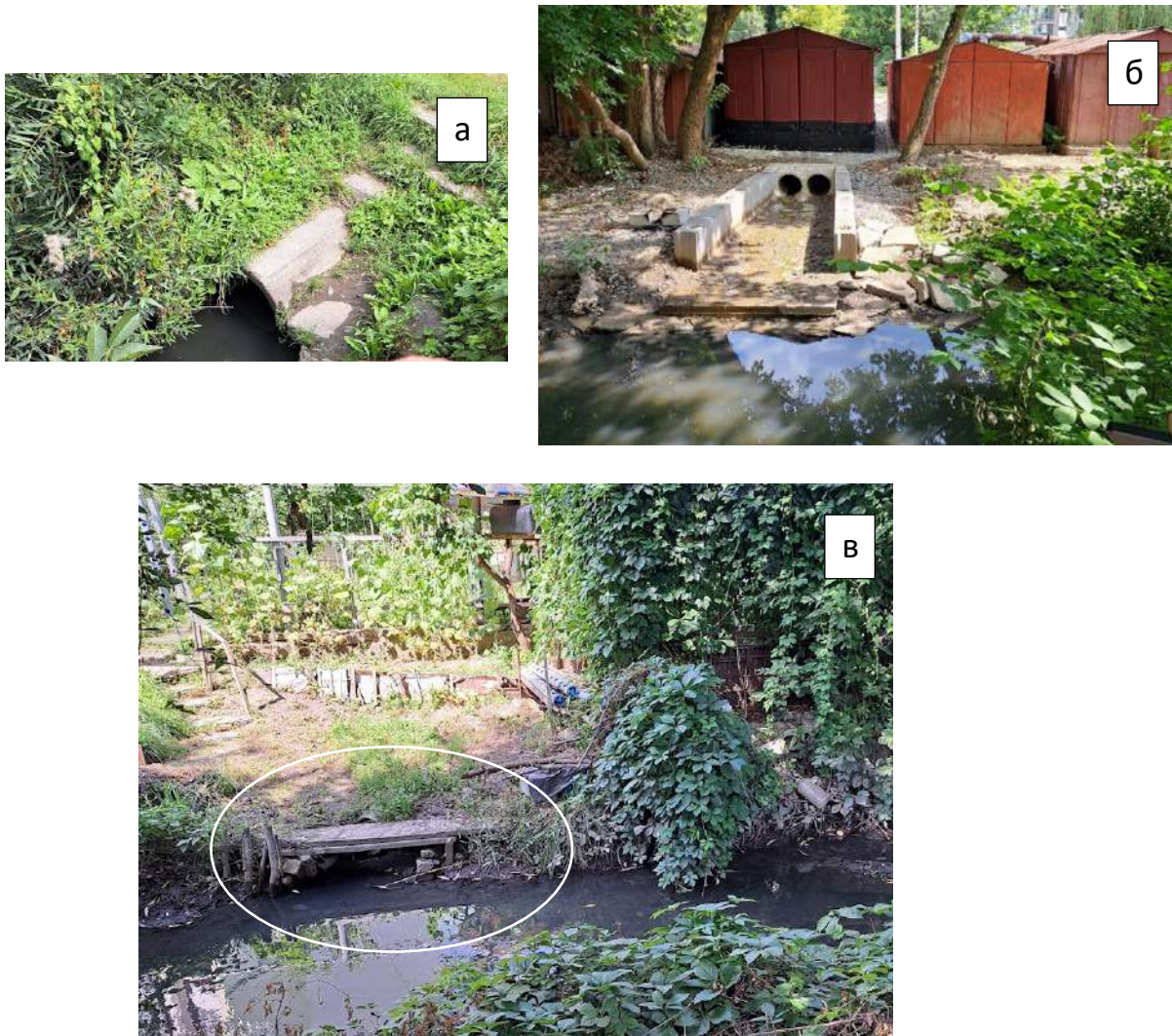
Рис. 2.7. Колектори: а – бетонна труба діаметром до 30 см; б - подвійний колектор діаметром по 60 см (біля нового ЖК) з лівого берега; в – труба, схована під сходиною біля приватного домогосподарства, правий берег.
