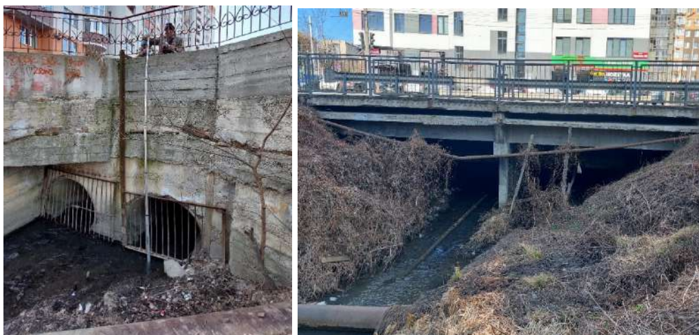
Фото 16-17 Вхід і вихід річки з підземного колектора.
